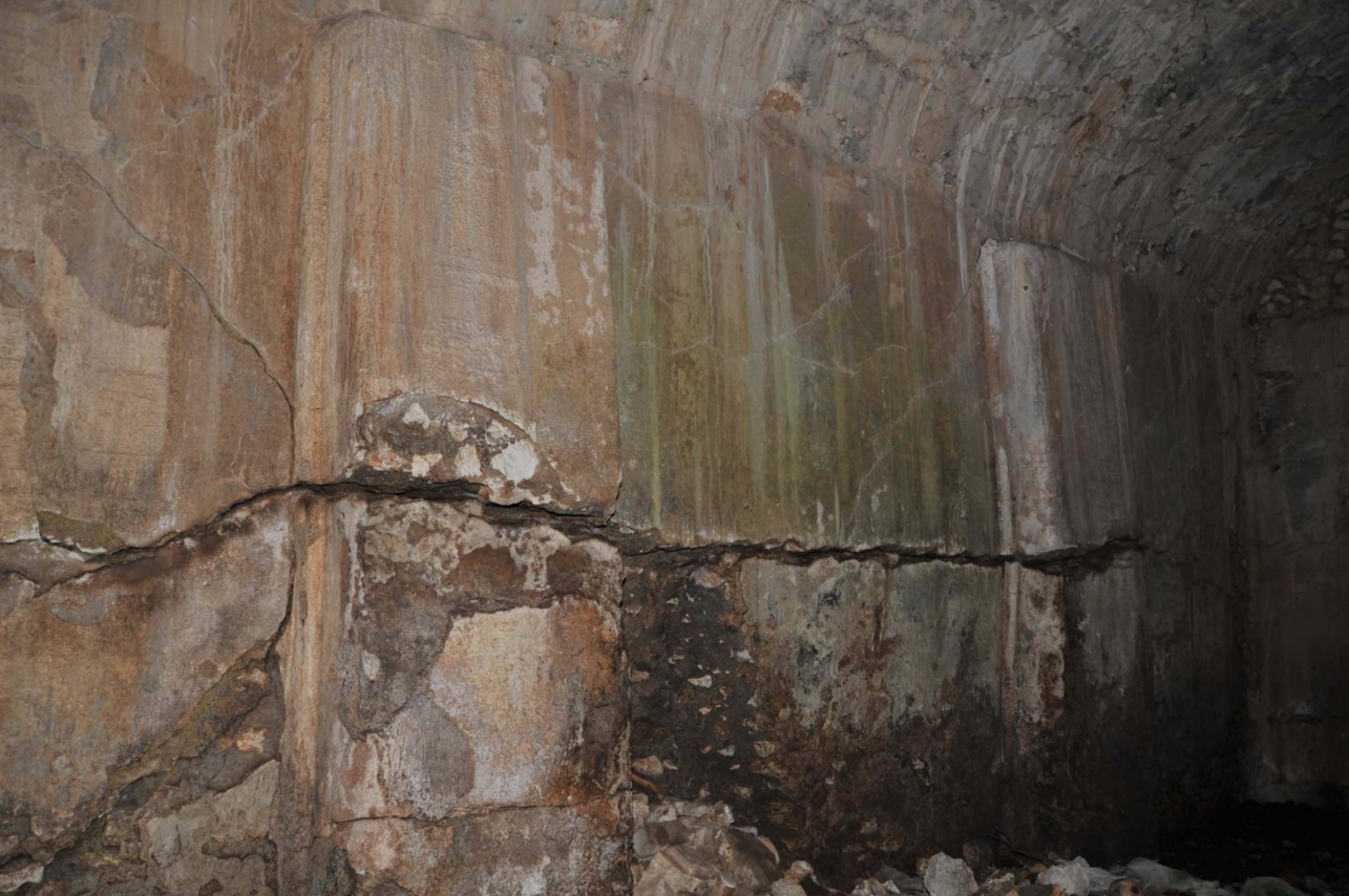
Lato perimetrale a sud-ovest, cedimento strutturale.
